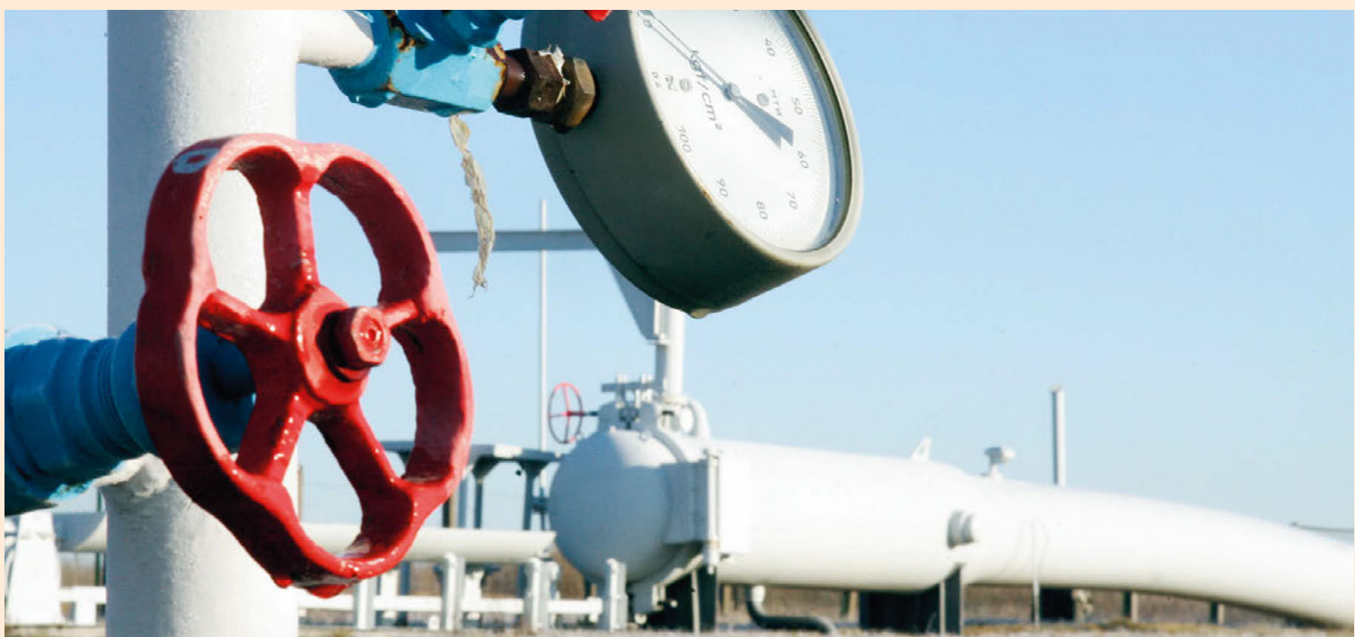
Η ΡΑΕ εκτός από το πρόστιμο ύψους 5 εκατ. ευρώ στον ΑΔΜΗΕ για καθυστερήσεις στο έργο του Δυτικού Διαδρόμου, έβαλε «φρένο» και στα σχέδια του ΔΕΣΦΑ για χρηματοδότηση του project FSRU Αλεξανδρούπολης και της υπόγειας αποθήκης αερίου στη Νότια Καβάλα από τους καταναλωτές.
